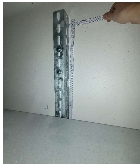
Binder Nr. 2 geänderte Ausführung der Kabelrinnenbefestigung und damit Dübelbefestigungen überhalb der Spannritzen
