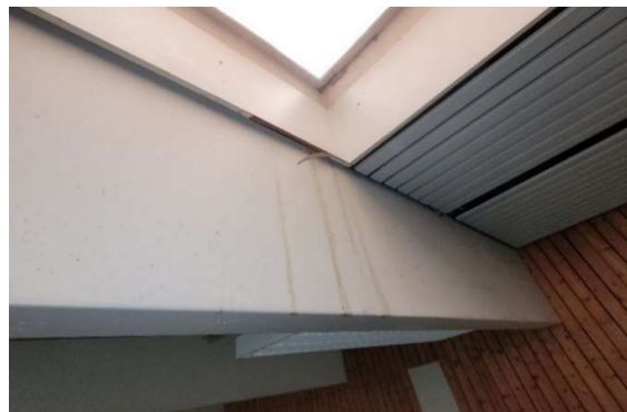
Wasserläuferspuren am Dachträger und Feuchteschaden an der Holzverkleidung vom Oberlicht
