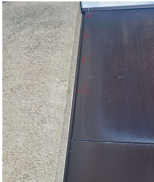
Fehlende Schrauben bei Vertikalstoß
