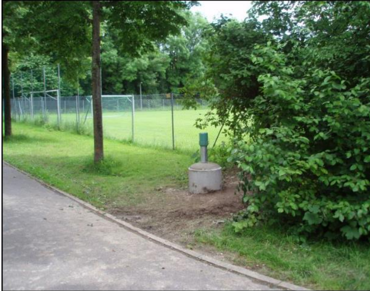
Vollausgebaute Grundwassermessstelle mit Fernwirktechnik (WWA LA) (Quelle: Oberes Grundwasser-Stockwerk: Stammdaten UNTERSBERG- WEG L 2 A (bayern.de))
