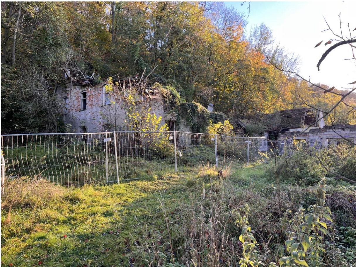
Abbildung 3: Einsturzgefährdete Gebäude entlang der Schönbrunner Straße.
