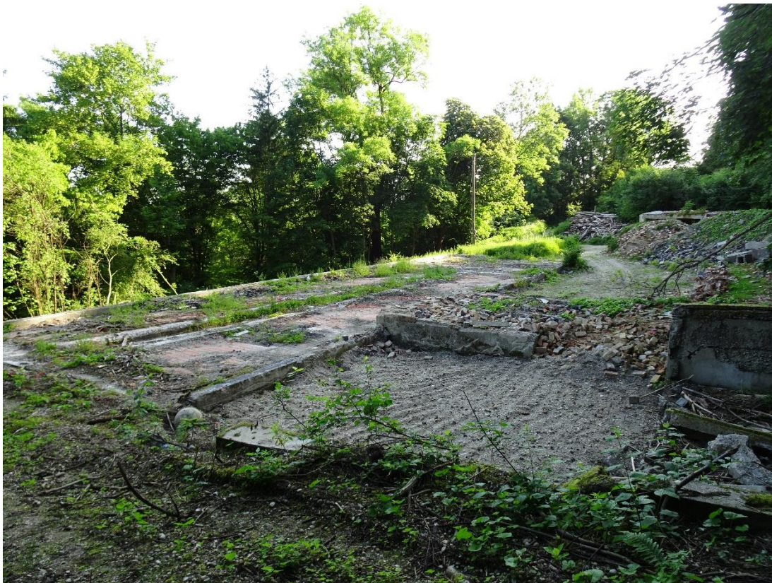
Abb. 4: Blick in Richtung Nordosten auf das UG, die bereits abgebrochenen Gebäude sowie die mit großen Bäumen bewachsene Böschung hin zur Schönbrunner Straße (Foto: 31.05.2023)
