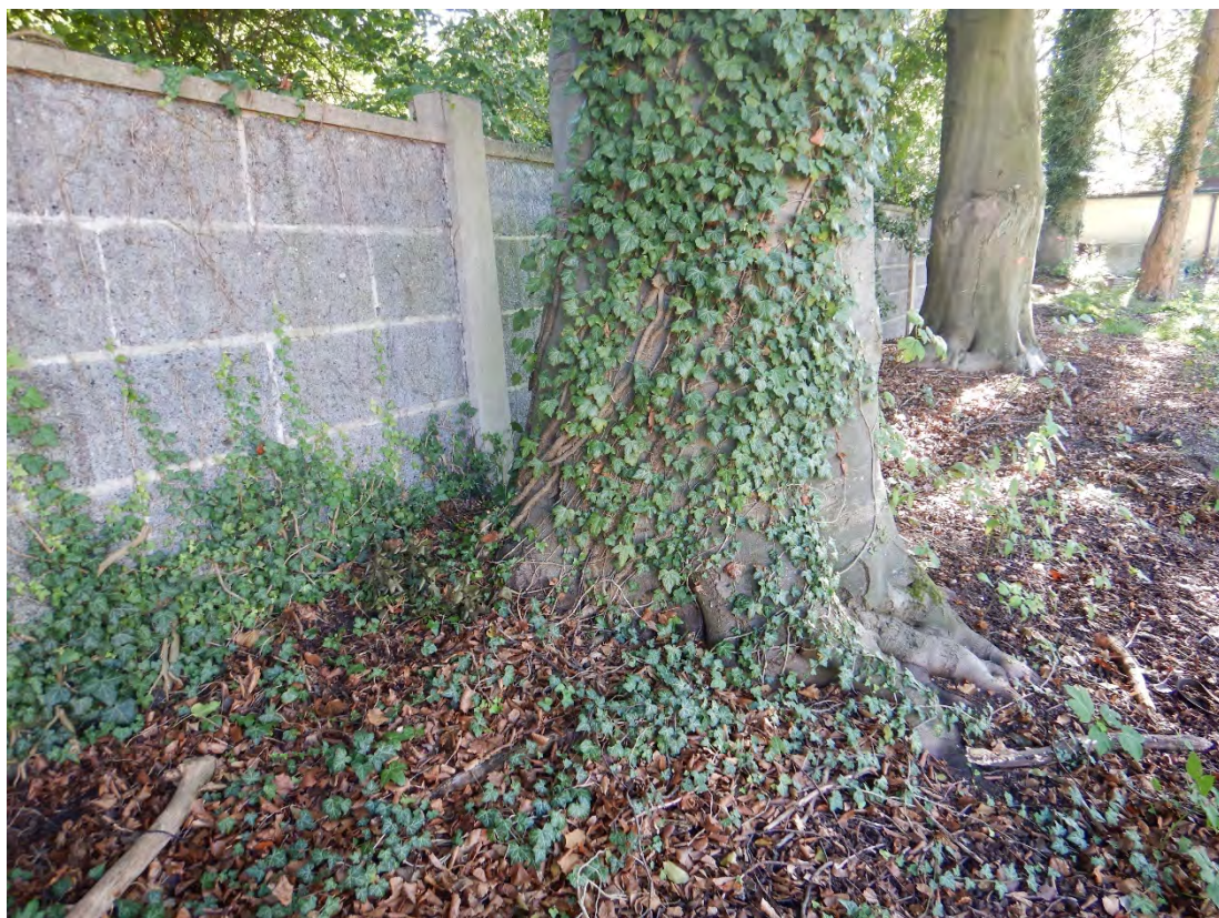
Stammfuß Baum Nr. 3, geringer Abstand zur Mauer
