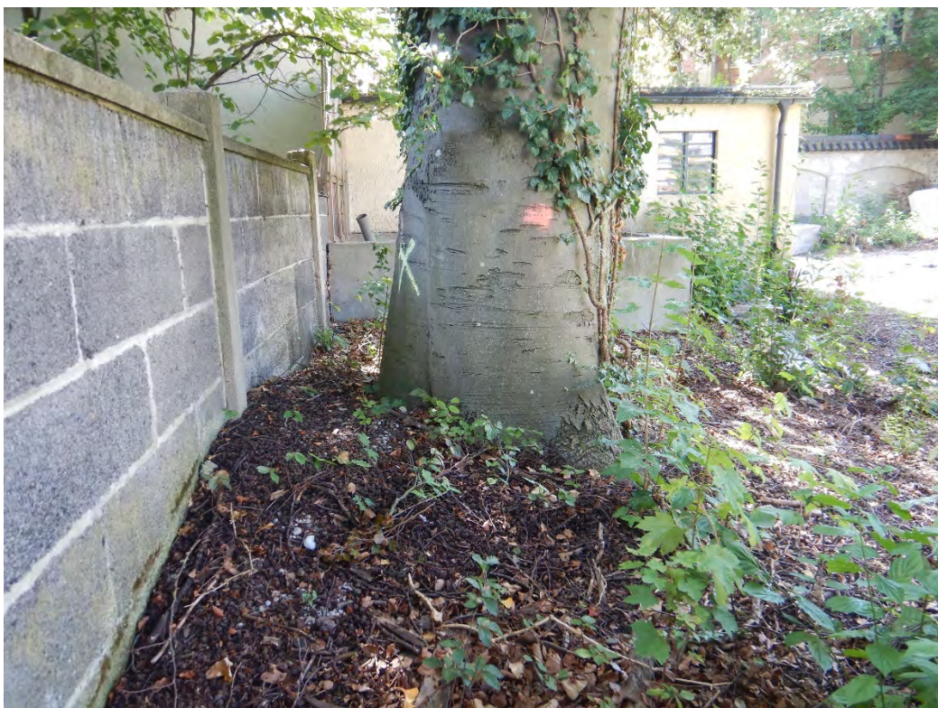
Anschüttung / Materialansammlung zw. Mauer und Baum Nr. 1
