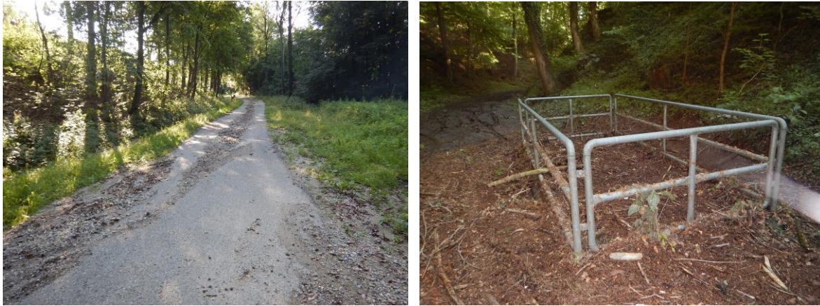
Abbildung 3.19: Betroffenheiten bei der Ortsbegehung am östlichen Fahrradweg (links), und verkleustes Auffangbecken (rechts)
