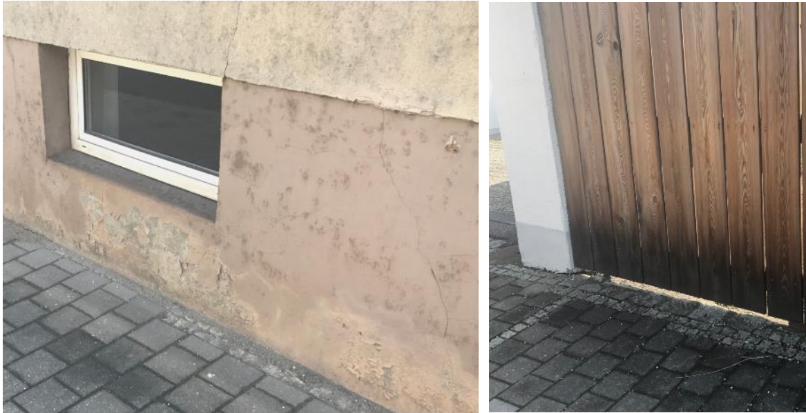
Abbildung 7.12: Wasserschaden an Hauswand (Hagrainer Straße 15) und Holzzaun (Hagrainer Straße 13)
