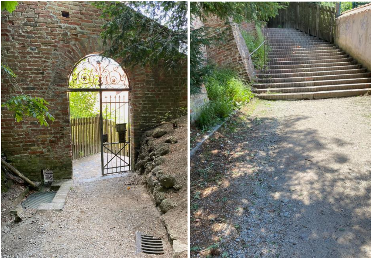
Abbildung 6.21: Kanaleinlauf am Ende des Hauptwegs; Erosionsspuren am Beginn der Kolpingstraße
