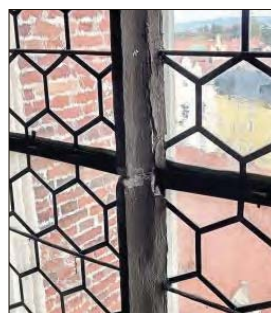
Hier ist es deutlich sichtbar: An der Verbindungsstelle zwischen Steinstrebe und Quereisen ist der Sandstein im Laufe der Jahrhunderte gebröckelt.
