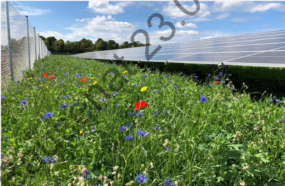
Abbildung 2: vergleichbare Unterkonstruktion im Solarpark Lichtenseer Moos
